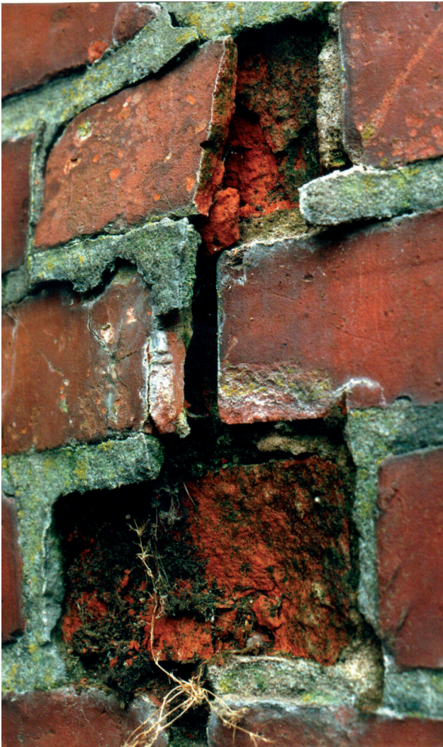
Abb. 6: Abplatzende Ziegelschalen am Niedersachsenstein in Worpswede
