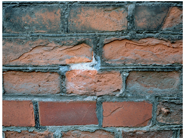
Abb. 10: Schadensbild des hydrophobierten und mit Zementmörtel verfugten Mauerwerks
