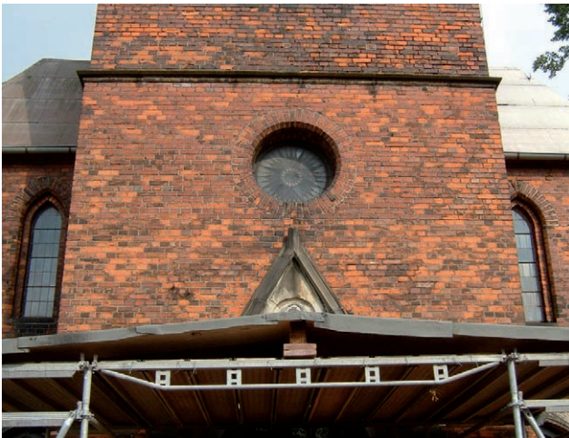
Abb. 9: Mit einem Gerüst überbauter Eingangsbereich der Kirche. Vom Turm lösten sich Ziegelschalen.
