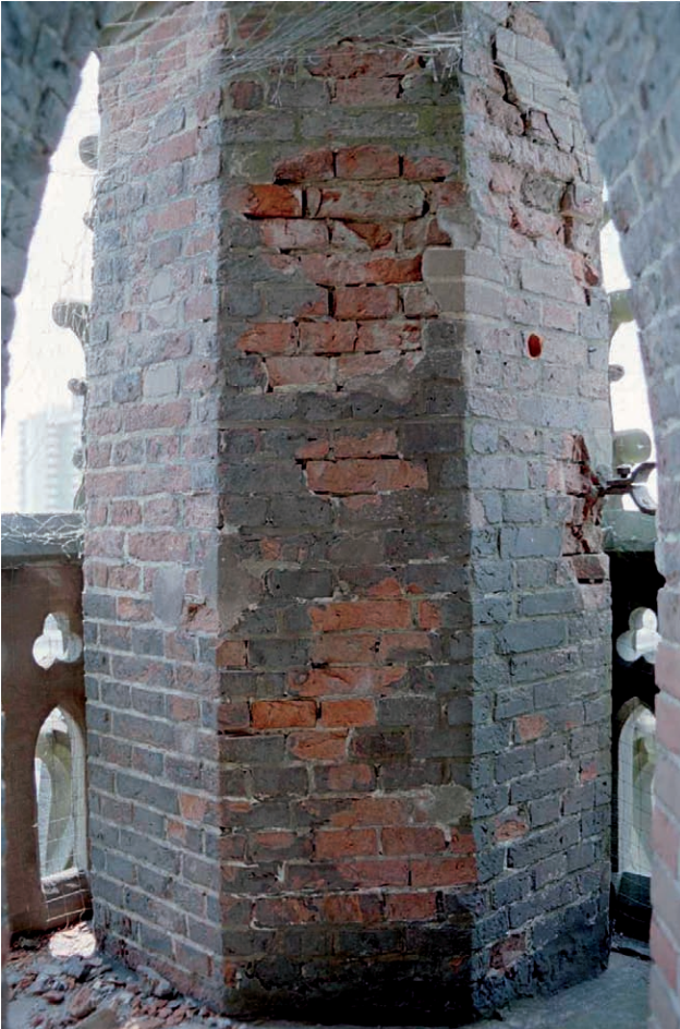
Abb. 2: Schadensbild an dem südöstlichen Ziegelpfeiler im Glockenturm der Bürgermeister-Smidt-Gedächtniskirche in Bremerhaven (2001). Bis zu einige Zentimeter dicke Ziegelschalen platzen aus dem Mauerverband.
