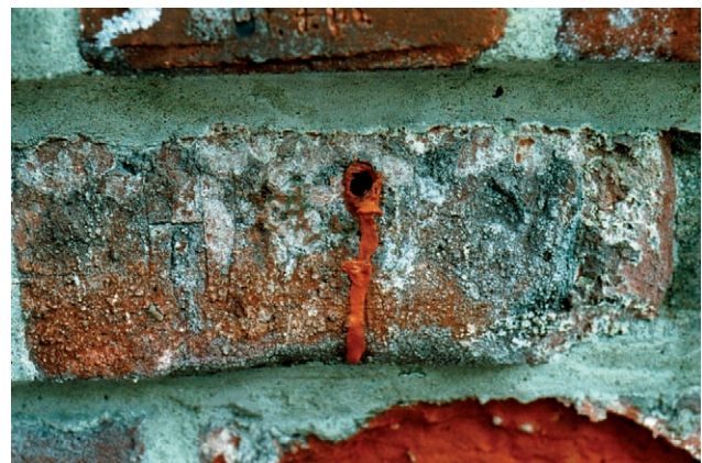
Abb. 8: Nach einer Spiralbohrung durch die hydrophobierte Oberflächenzone floss Wasser aus dem Bohrloch (Niedersachsenstein in Worpswede).
